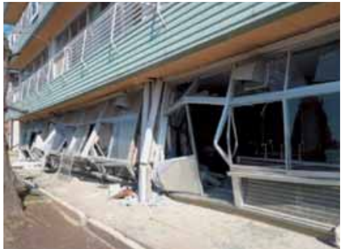
沈む南校舎 (本宮市立本宮第二中学校提供)
